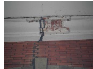
図 2-7 煉瓦壁亀裂_正面玄関棟内側
