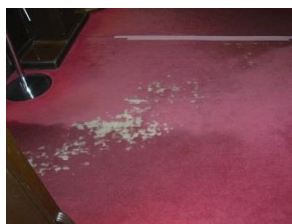
図 2-15 カーペット敷_記念室
