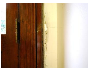
図 2-20 漆喰壁の亀裂_1階中央廊下
