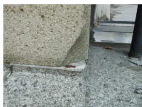
図 2-1 基礎石の割損_西面
