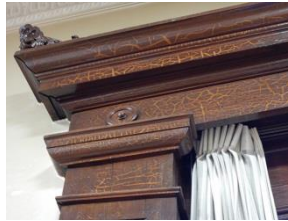
図 2-25 窓枠塗膜の劣化_2号会議室
