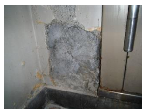
図 2-21 壁の剥落_地階主階段室
