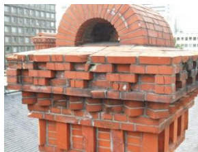
図 2-12 煉瓦張の剥落とエフロレッセンス_換気塔
