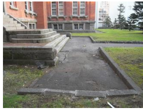
図 2-5 アスファルト敷の不陸_裏階段
