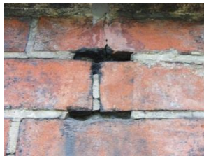
図 2-8 煉瓦目地欠失_西面
