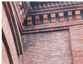
図 2-9 入隅部での煉瓦壁汚損_東面
