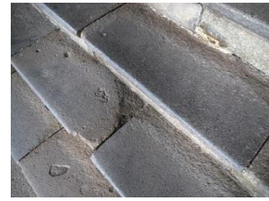
図 2-6 石段の摩耗と割損_正面玄関棟
