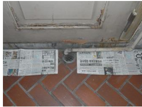
図 2-24 鉄扉の発錆_地階主階段室
