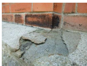
図 2-2 基礎石天端の表面剥離_西面
