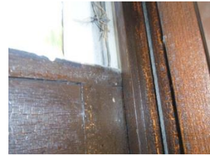
図 2-26 上下窓の破損_文書館閲覧室
