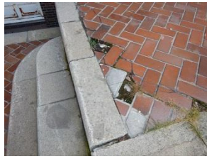
図 2-4 煉瓦葺の割損と欠失_裏階段
